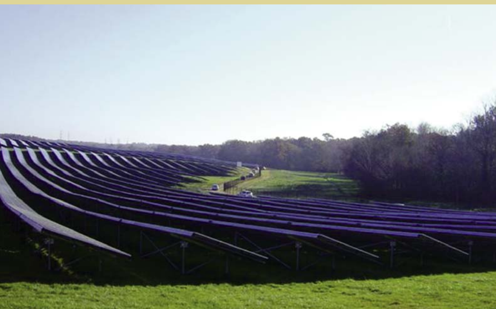
Centrale photovoltaïque de Petit-Palais-et-Cornemps (33)
