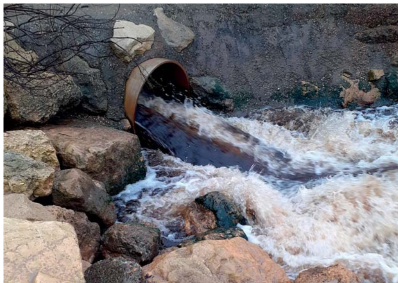
Rejet exutoire du Massurat, plage de Fontainevieille, 2 mars 2024
